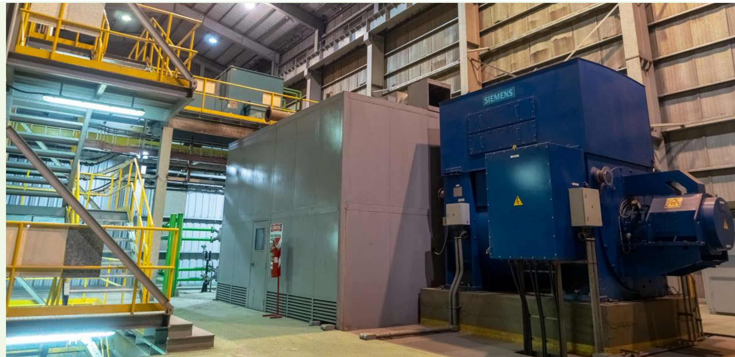
Turbogenerador Siemens N° 4.
