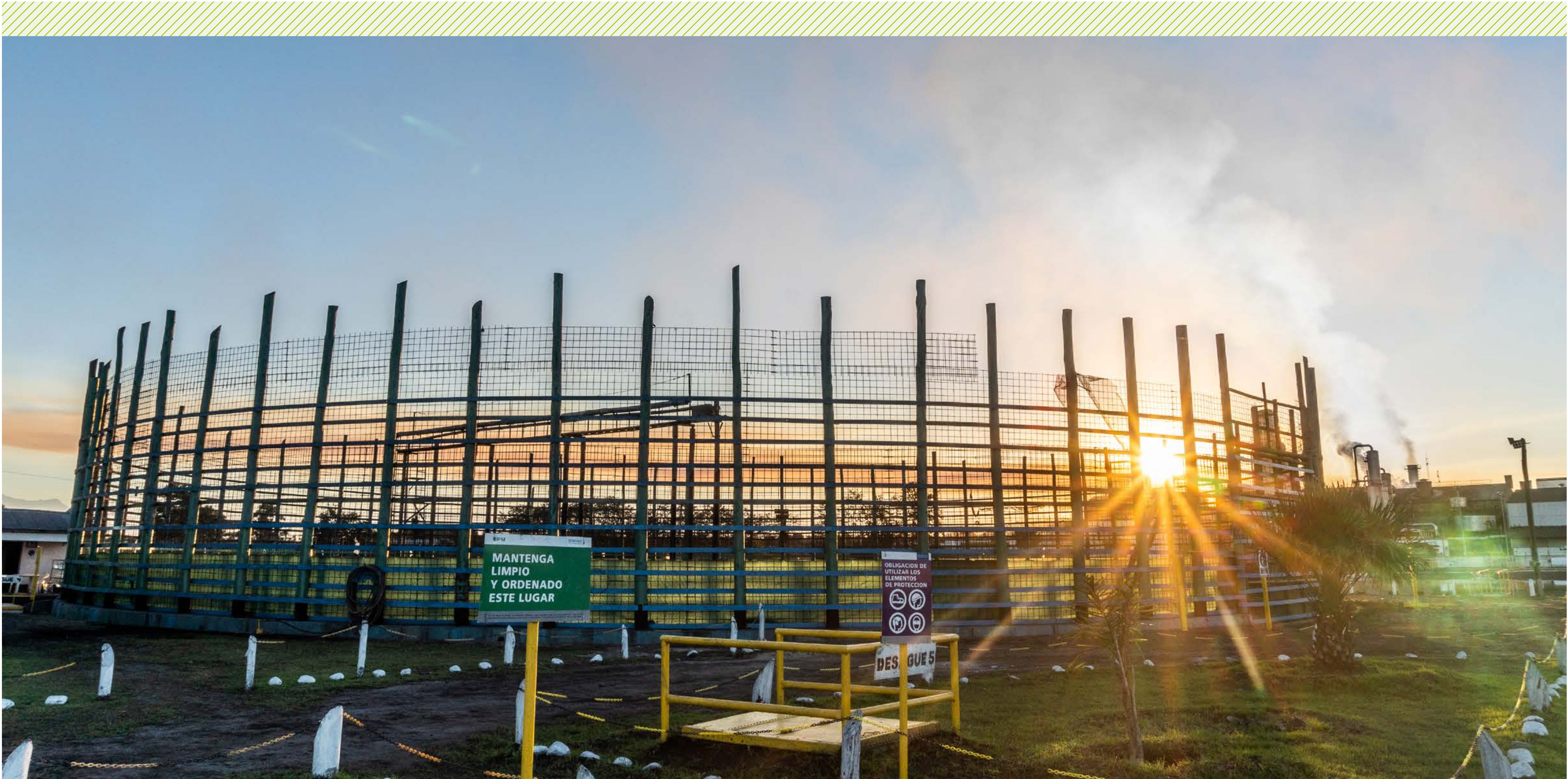
Filtro de cenizas de caldera.
